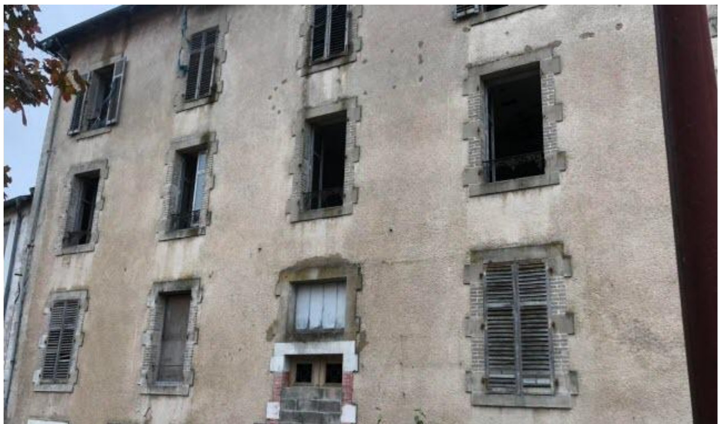
Parfois squattés, ces bâtiments menacent de s'effondrer. Photo Aury Bouzar-Essaidi
